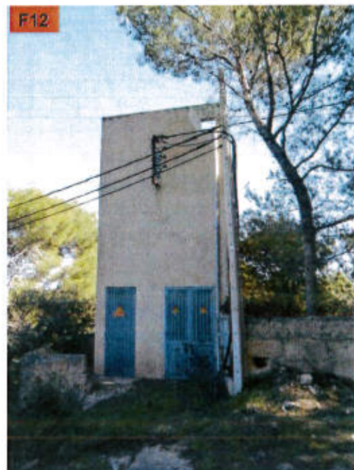
F12. Centre transformador existent en el C/ Bellavista.
